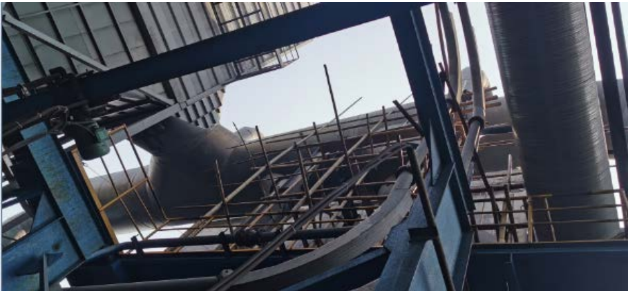
三炼焦除尘器进口
