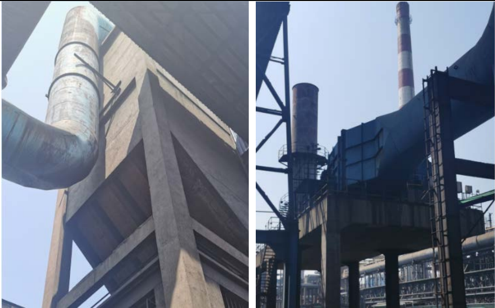
5-6#装煤除尘器进口
